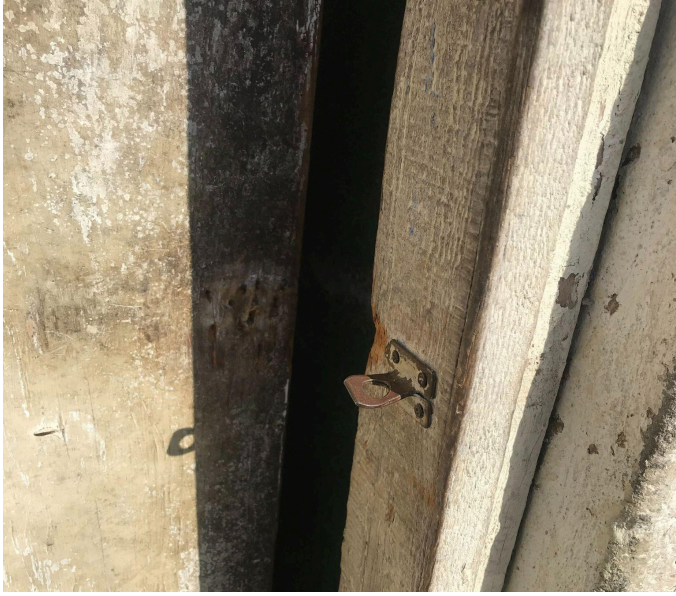
Darina's (eyewitness 2) door missing the latch and lock La puerta de Darina (testigo 2) perdió el pestillo y la cerradura
